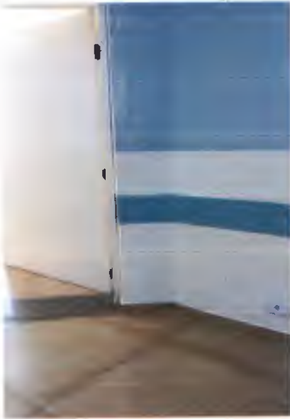
Paredes com infiltrações
